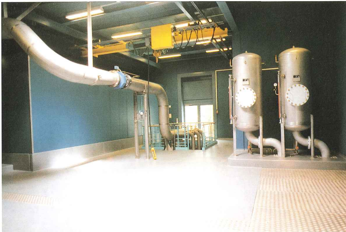
Pompage eau brute et ballons anti-bélier (refoulement eau traitée)
