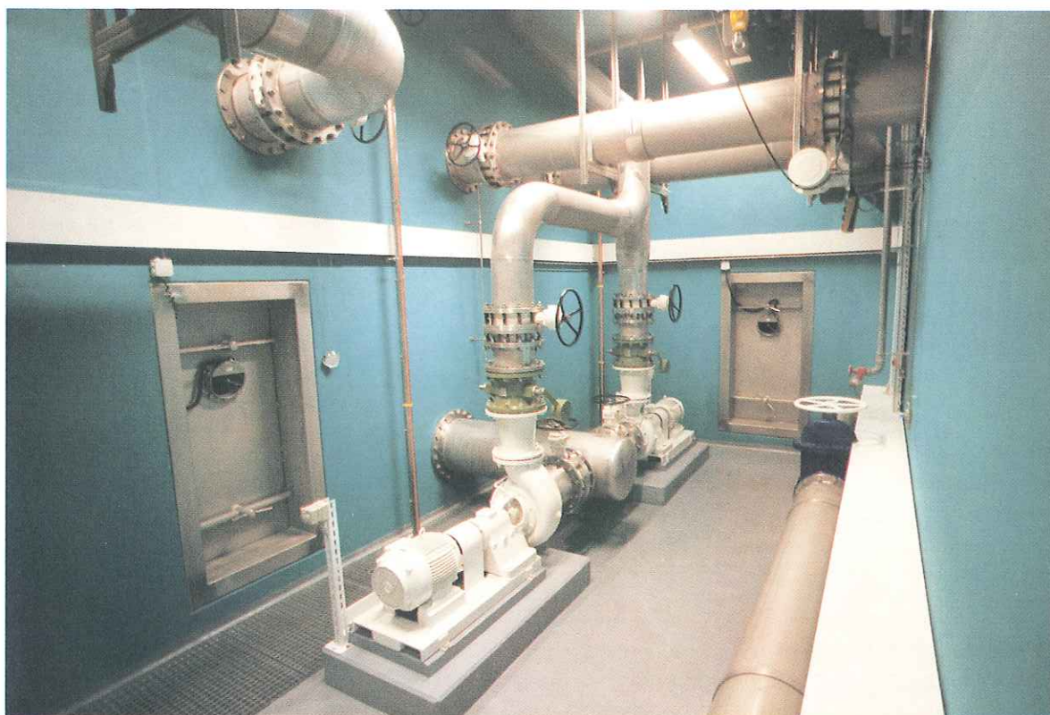
Cuve et pompes d'eau de lavage des filtres, réservoir est
