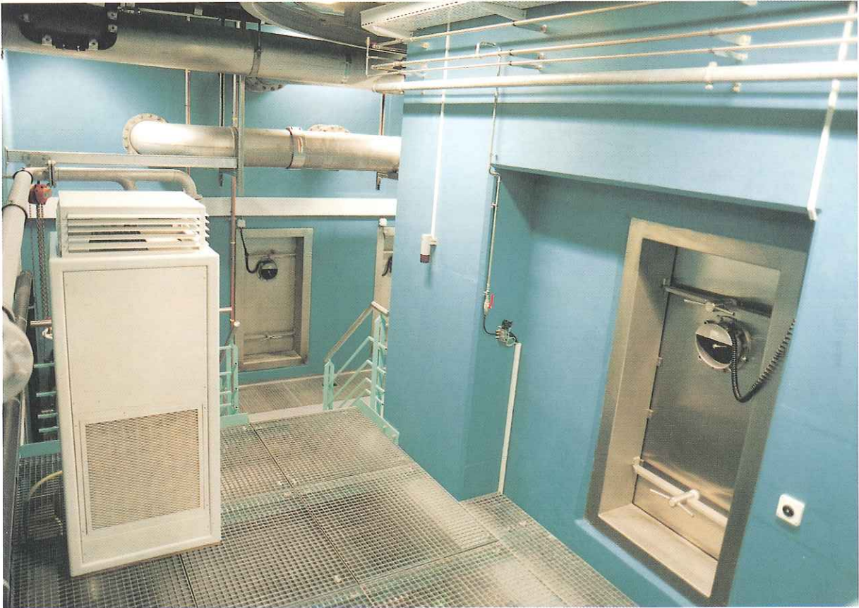
Chambre de mélange et réservoir sud, déshumidificateur
