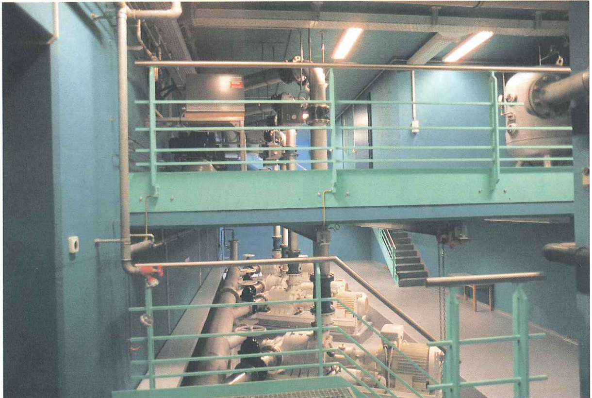
Refoulement eau traitée et production d'air comprimé pour ozonation
